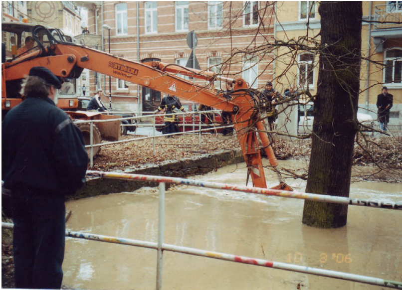
Abbildung 11.3: Räumung am Leutra-Rechen 2006 (Quelle: Stadt Jena)
