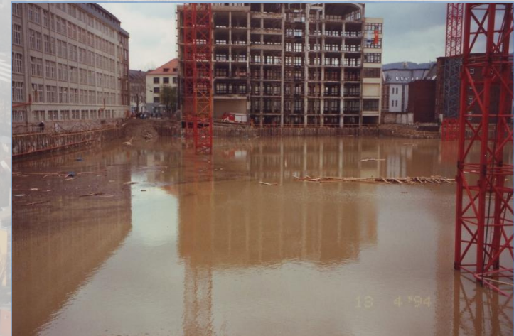
Hochwasser an Saale und Leutra (Quelle: Knopf 2013, Stadt Jena 1994)
